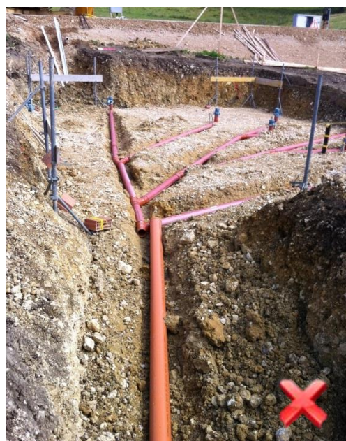
Canalisations SANS assise bétonnée !
