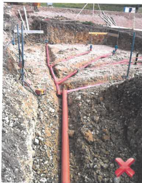
Canalisations SANS assise bétonnée !
