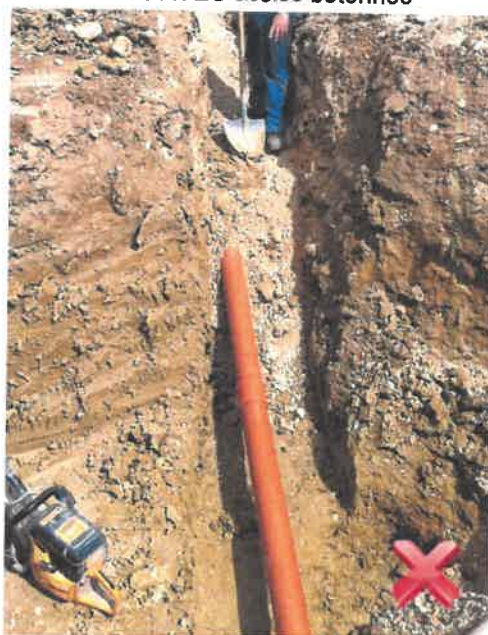
Canalisation non bétonnée !
